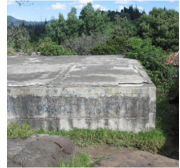
Tanque de agua
