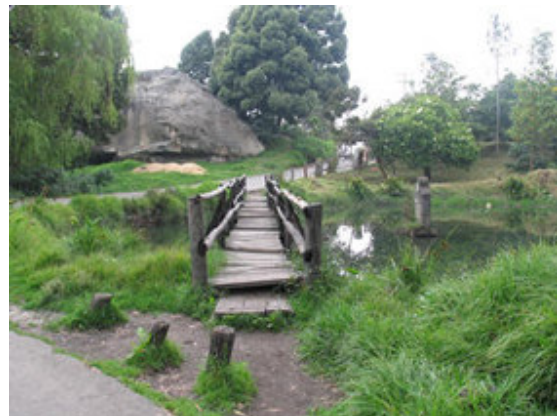
Puente en malas condiciones sobre el laguito de la entrada
